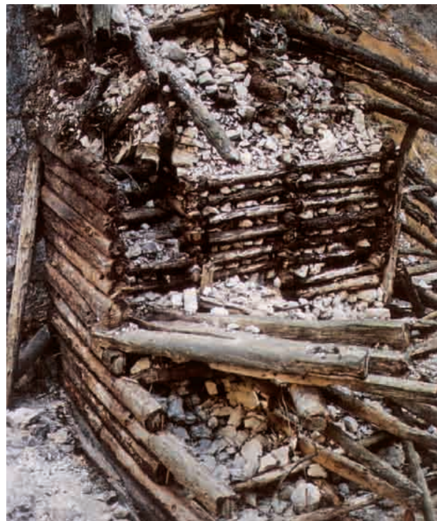
I resti della chiusa inferiore del rio Tralba in Comune di Moggio Udinese, opera realizzata completamente in pietra e legname di pino nero. Lo studio degli accrescimenti diametrici ha permesso di fissare attorno al 1780 la data di costruzione dell'opera.
