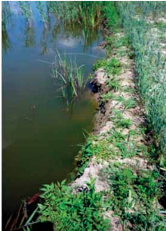
Fig. 9 - Particolare di un argine interessato dall'attività di scavo dei crostacei e già parzialmente crollato.
