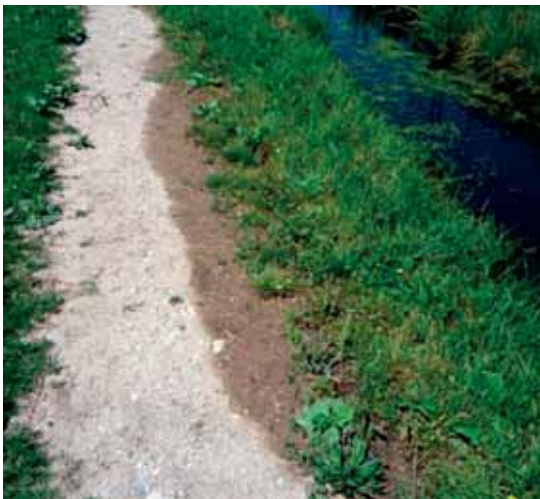
Fig. 10 - Evidente infiltrazione spondale interessante un tratto di circa 20 metri.
